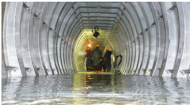
L'adduttore idrico di Caposele che rifornisce la Puglia
